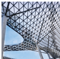
Structures en Acier
